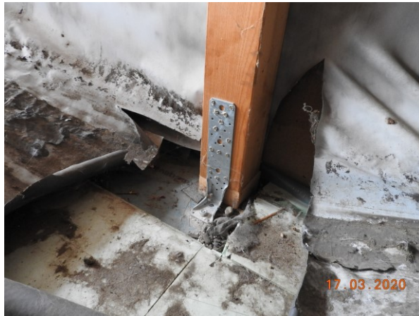
Abbildung 6: Bodenanschluss Dachstuhl / keine Spuren (17.03.2020)
