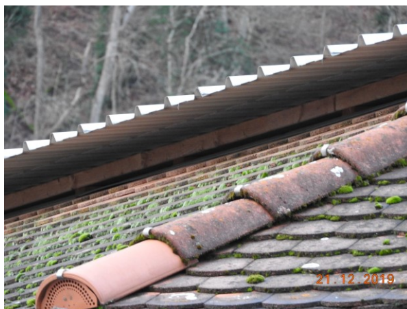
Abbildung 4: von außen sichtbare Spalten im Dachüberhang (21.12.2019)
